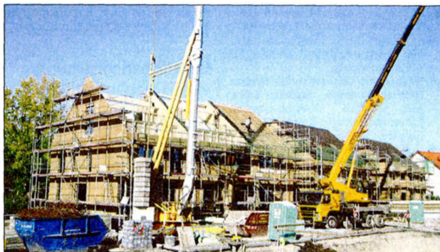
Im Oktober fand bei den ersten Häusern der insgesamt 51 geplanten Wohneinheiten das Richtfest statt. Fotos: Gruber Naturholzhaus
